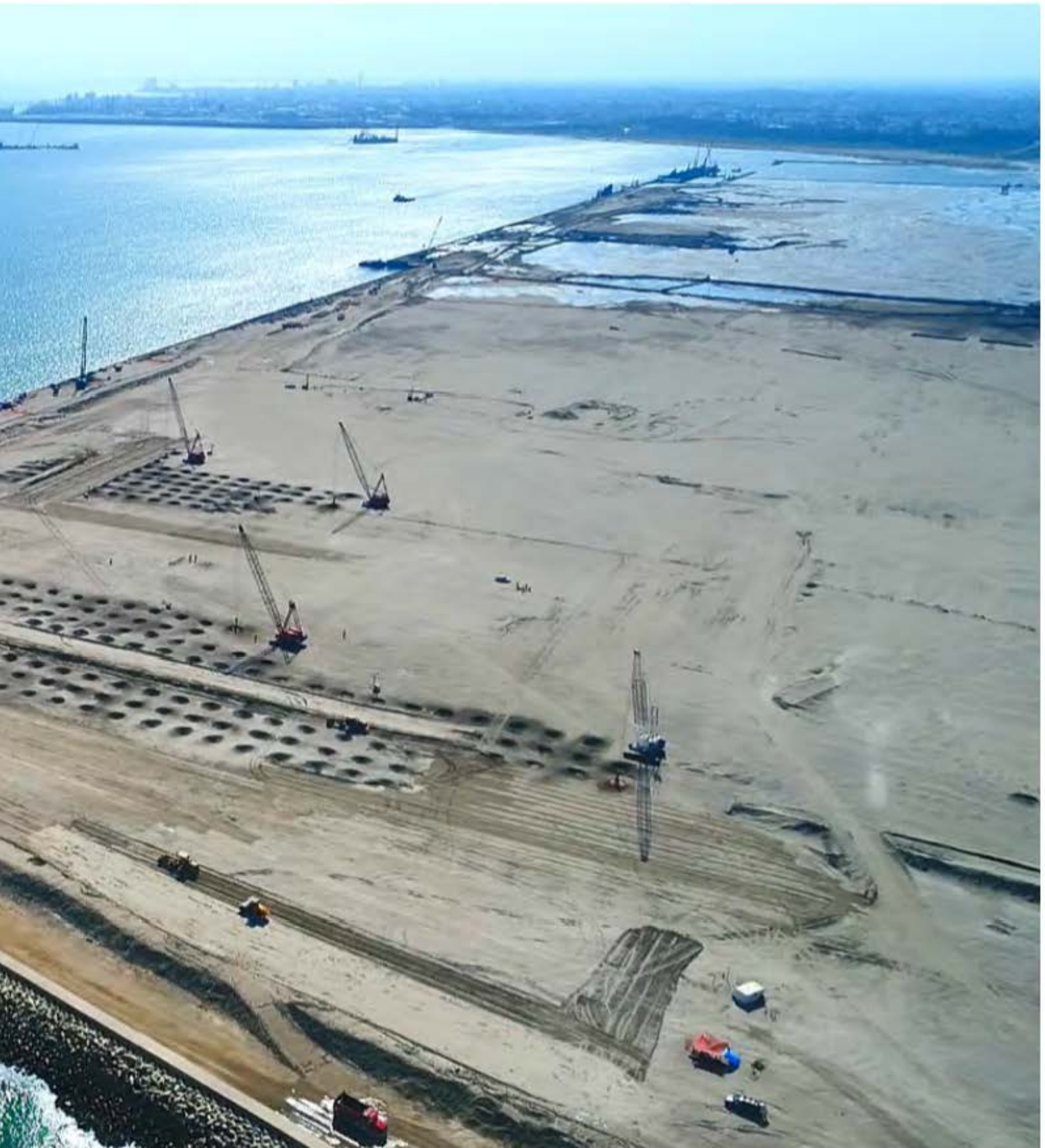
Nuevo Puerto de Veracruz. Durante el segundo semestre del año 2017 se concluyó la escollera, se avanzó en el dragado del canal de navegación y en el relleno de los muelles con lo que se alcanzó el 70% de avance general.
