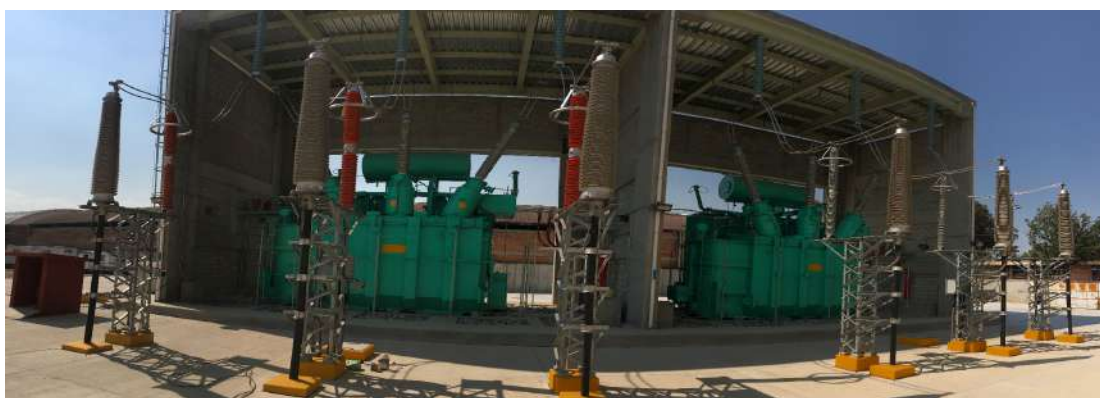
Fotografía: SE Culhuacan Bcos. 1 y 2 SF6 + MVar
