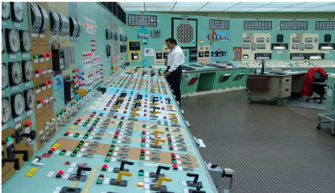
Vista del cuarto de control principal
