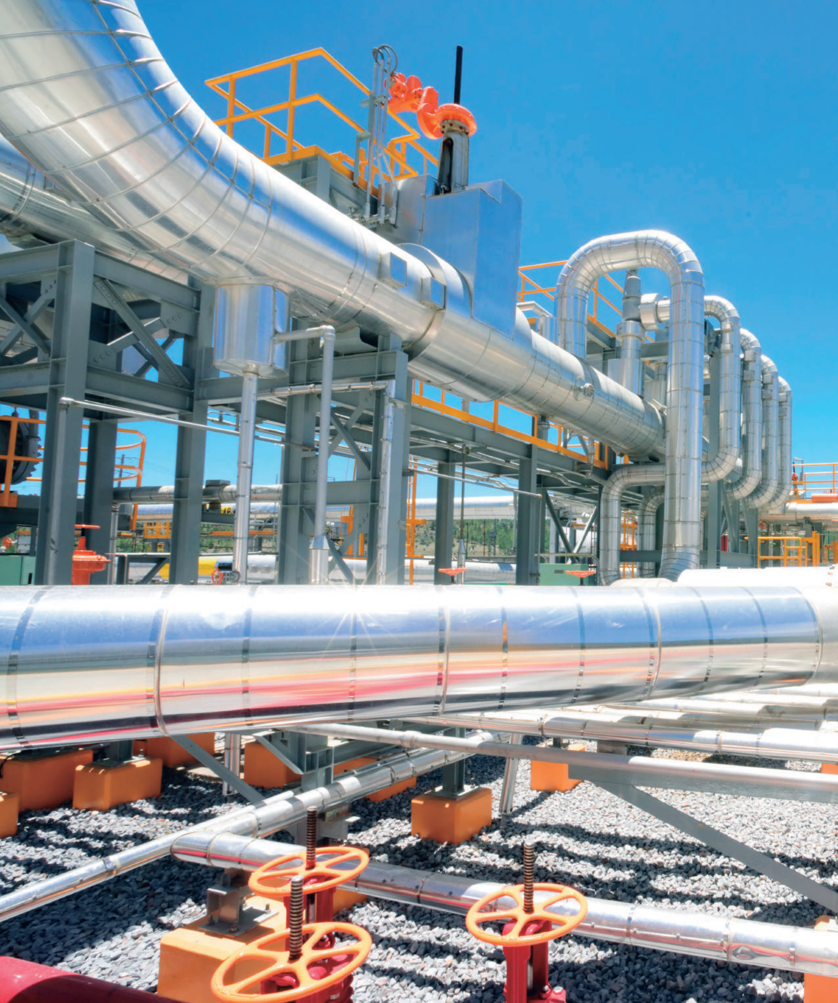
Fotografía 38. Central geotérmica. Chignautla, Puebla. Comisión Federal de Electricidad.
