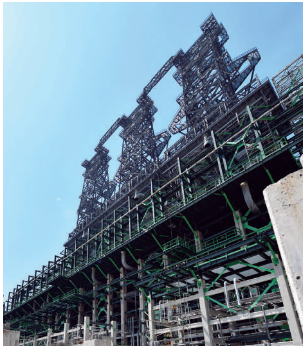
Fotografía 23. Planta coquizadora de la Refinería Miguel Hidalgo. Tula, Hidalgo. Petróleos Mexicanos.
