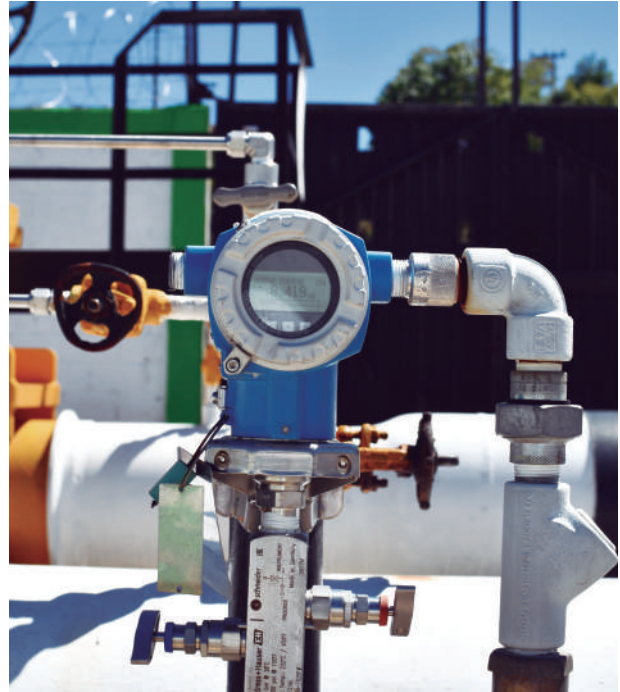
Fotografía 6. Paso de regulación. Santa Ana, Estado de México. Comisión Federal de Electricidad.
