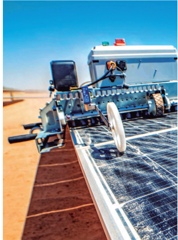
Fotografía 26. Robot limpiando equipo fotovoltaico. Puerto Peñasco, Sonora. Comisión Federal de Electricidad.
