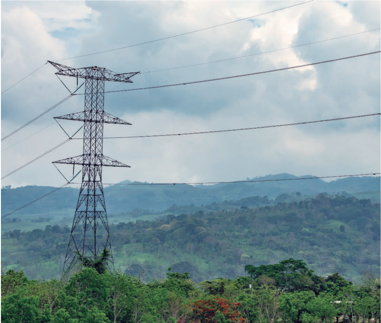
Fotografía 29. Líneas de transmisión. Tuxtla Gutiérrez Chiapas. Comisión Federal de Electricidad.
