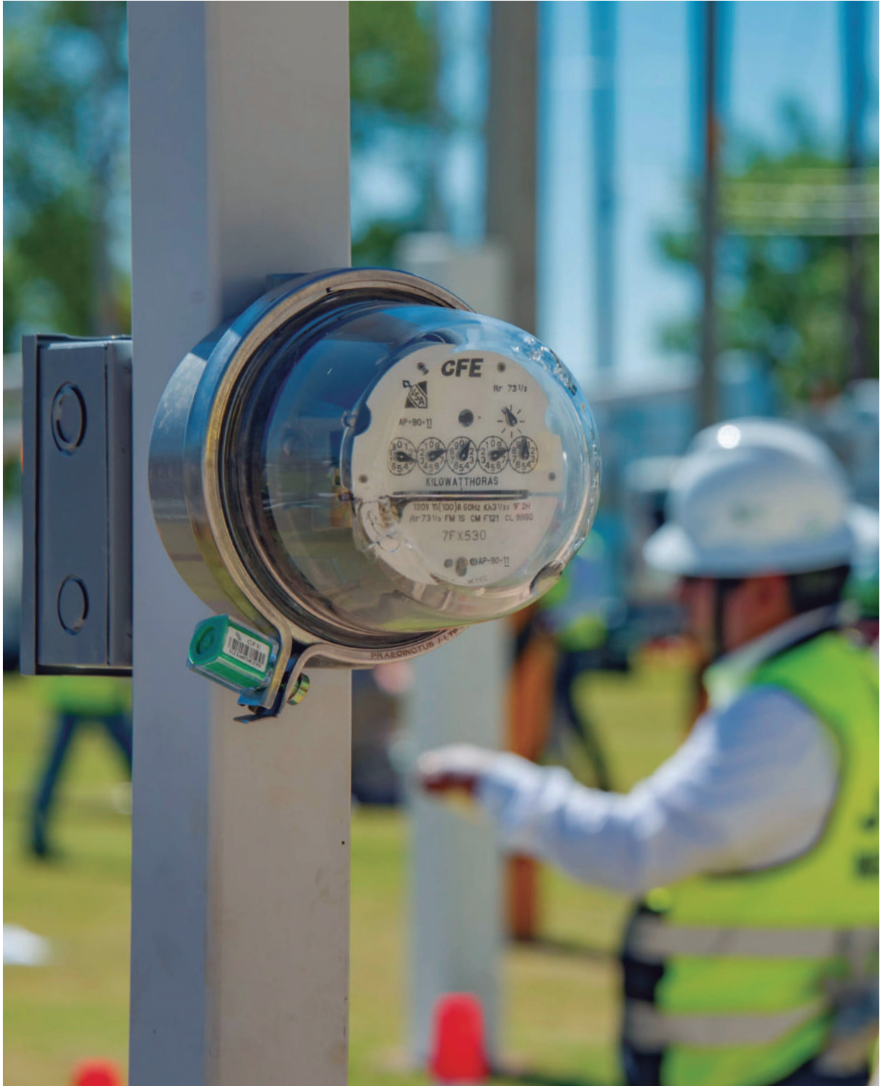
Fotografía 43. Medidores domésticos. Comisión Federal de Electricidad.
