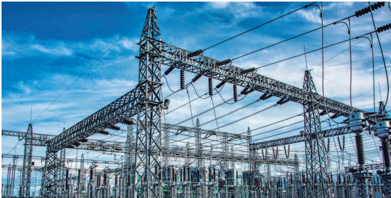
Fotografía 27. Subestación en la Presa Libertad. Monterrey, Nuevo León. Comisión Federal de Electricidad.
