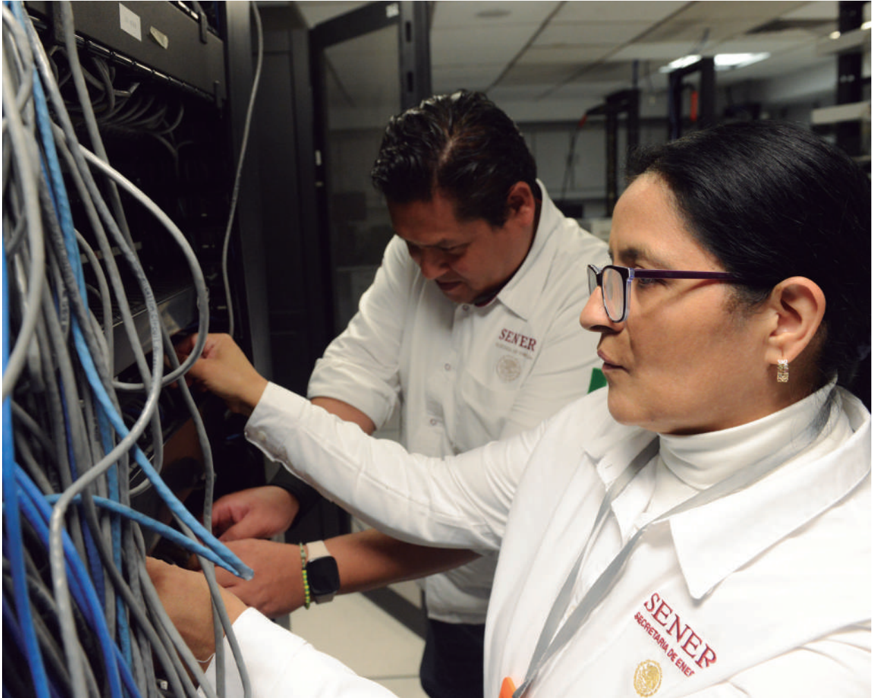
Fotografía 51. Mantenimiento en zona de servidores. Ciudad de México. Secretaría de Energía
