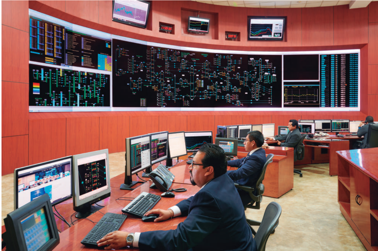
Fotografía 34. Sala de control de la Gerencia Oriental. Puebla, Puebla. Centro Nacional de Control de Energía.
